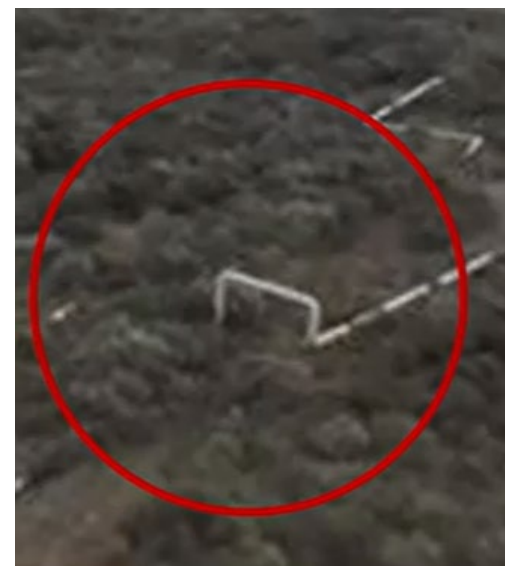
図19)オルカリヤ地熱発電所 パイプライン
