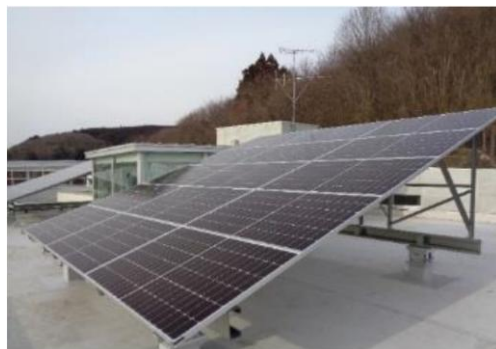
▲太陽光パネル(坪沼小跡施設)
